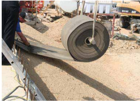
CC se desenrolla desde la cabeza y hacia el pie del talud con un solape de 100mm entre las láminas
