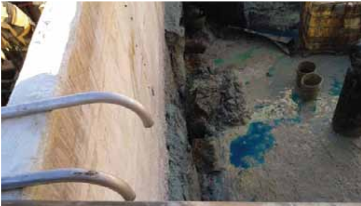
Depósito de aguas ácidas deteriorado por el uso
