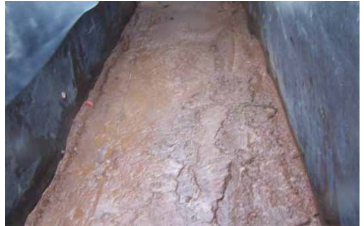
No se evidenciaron cambios en el sustrato por las filtraciones laterales
