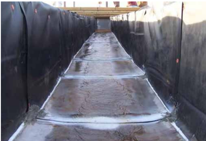
Juntas pintadas para ayudar a detectar los movimientos
